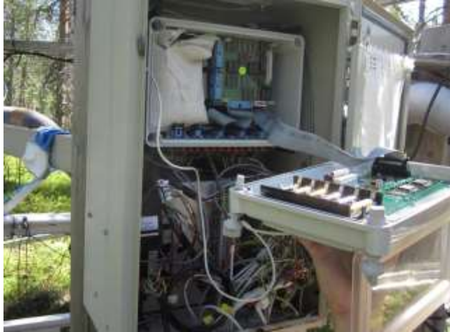
Kuva 13-1 Sääloggeri, josta kansi on irrotettu. Patterit näkyvät kuvassa.
