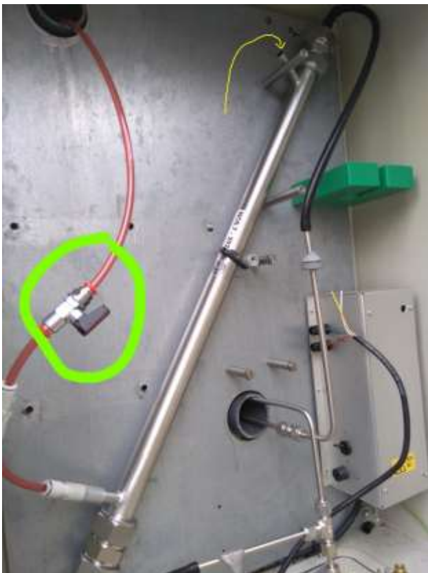
Kuva 5-3 Aerosolikuivain kaapissaan, avattava venttiili ympyröity ja virtauksen mittaamiseen käytettävä aukko osoitettu nuolella
