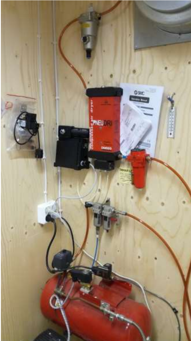
Kuva 2-123 Paineilmalinjaston suodattimet/vedenerottimet, automaattinen vedenpoistventtiili ja paineilmakuivain.
