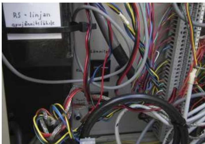
Kuva 13-2 Sääloggerin sisuskaluja, kaapin lämmityskytkin "Lämmitys"-tekstin alapuolella.
