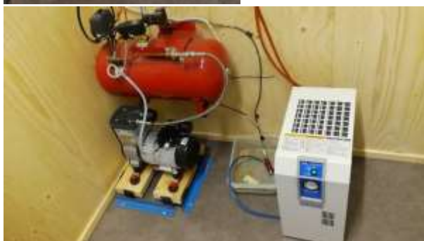
Kuva 2-112 Yläkuvassa kompressoripumppu (Kaeser) ja (keltainen) painesäiliö ja alakuvassa jäädytinkuivain (SMC IDFA3E)
