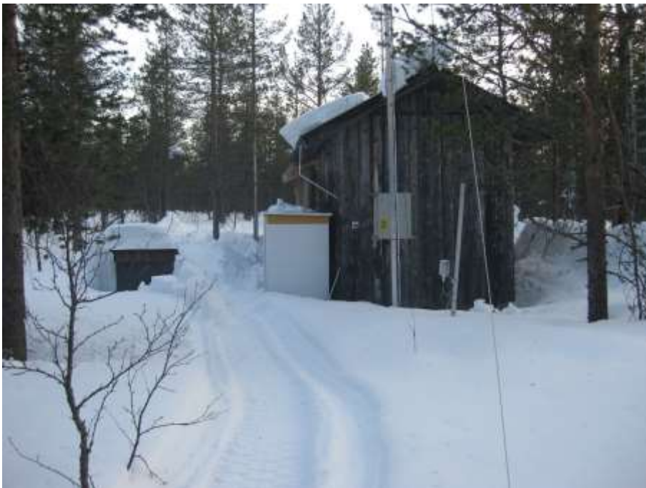
Kuva 8-1 Pumppukoppi (valkoinen metallikaappi) aseman ulkopuolella.
