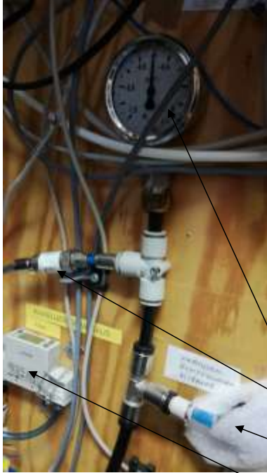
Kuva 2-4 Kaasunäytelinjan päävirtauksen virtausmittari (SMC PFM7), kriittinen aukko (liittimen sisällä, teippauksen nuoli osoittaa virtaussuunnan), pumppulinjan alipainemittari ja alipaineanturi.
